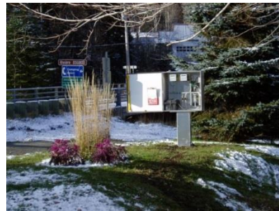
Figure 1 – Station hydrométrique- Source : www.mddelcc.gouv
